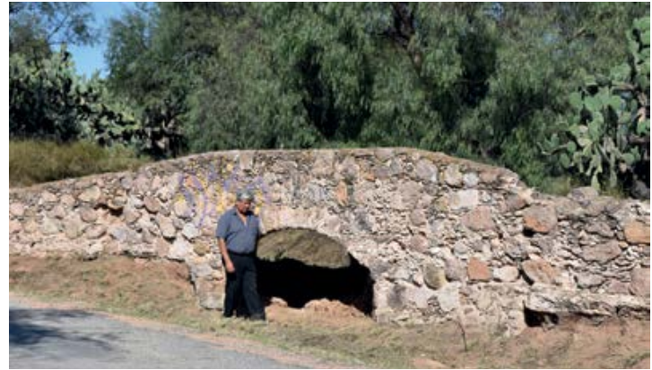
Restos del antiguo puente El Verde, ubicado a unos 5 km de la cabecera municipal de Villa de Reyes, S.L.P.
